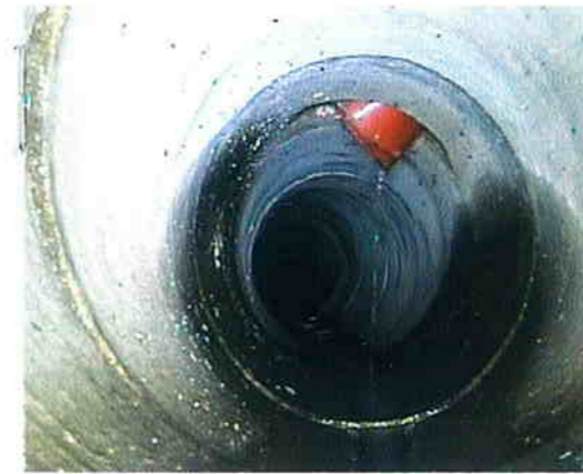
Bild oben: Private Hausanschlüsse sollten fachkundig verlegt werden. Bild unten: Ein ungesicherter Hausanschluss ragt in eine Hauptleitung.
